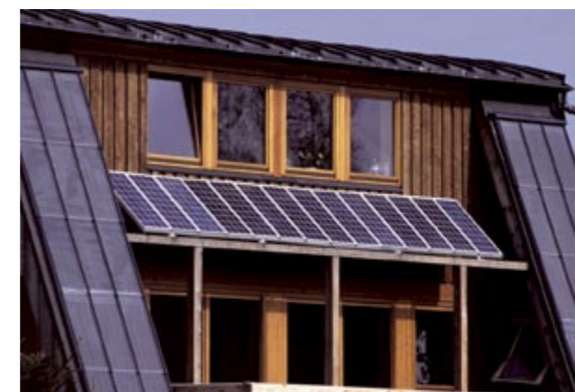
Рис. 7. Солнечные батареи на крышах домов
